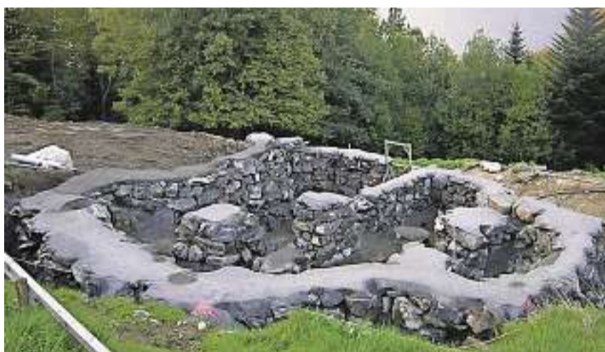
Natursteinmauern bilden das Fundament: Die verwendeten Steine stammen alle aus dem Aushubmaterial. Bild Familie Gwerder
