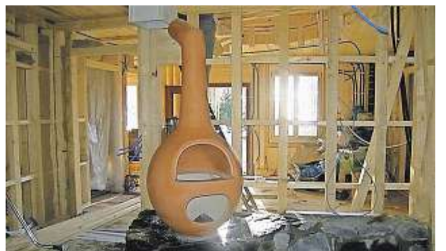
Tonofen im Wohnbereich: Damit kann das ganze Haus geheizt werden. Zudem wurden auch ein Kochfeld und ein Backofen integriert. Bild Familie Gwerder
